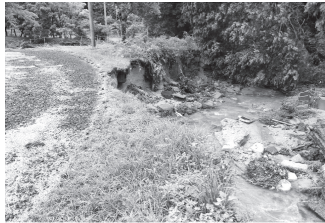
▲昨年8月13日の大雨で崩落した里道の様子
