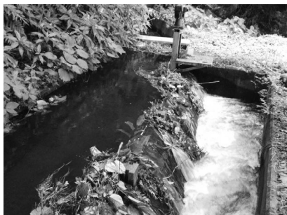
刈草が詰まり水路が溢れている様子
