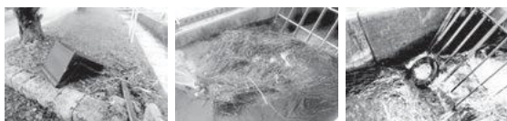
水路に投棄されたソファ 水路に詰まった刈草 水路に投棄されたタイヤ
