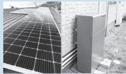
▲個人住宅太陽光発電設備と蓄電池
