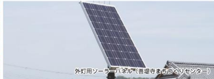
外灯用ソーラーパネル (菩提寺まらるくりセンター)
