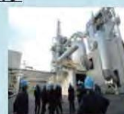
バイオマス発電所
