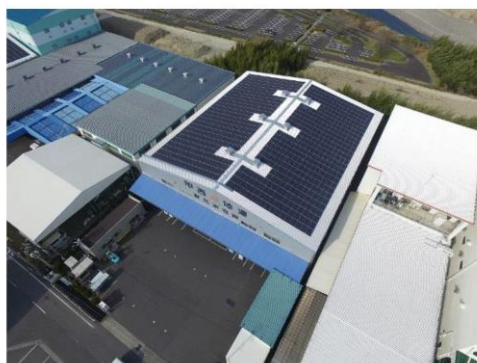
グリーンボンドを活用した 太陽光発電設備
