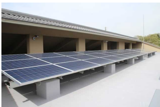
太陽光パネル（屋上）
