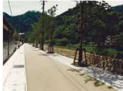
石積みのパラペットによる嵩上げ（津和野川（島根県）） （出典：河川景観の形成と保全の考え方 参考資料国土交通省）
