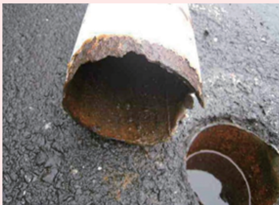
ポールの根腐れによる倒壊
