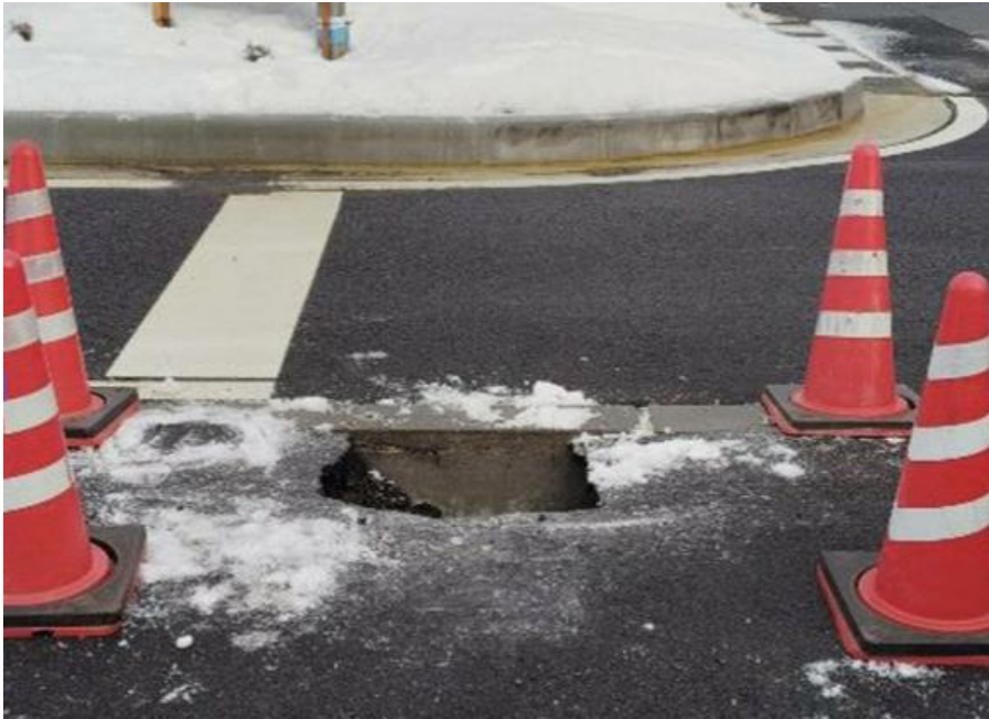
【道路陥没事故】
