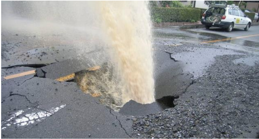
【漏水事故状況】
