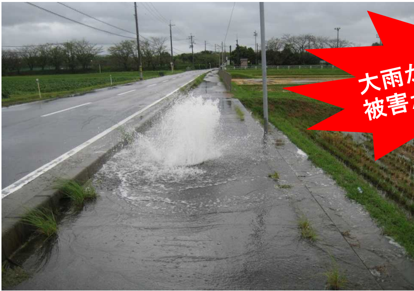
マンホールから汚水があふれ出る様子
