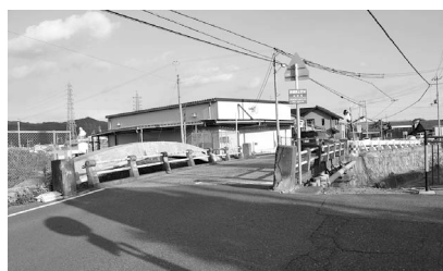
老朽化する落合川橋
