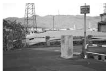
老朽化が進む落合川橋
