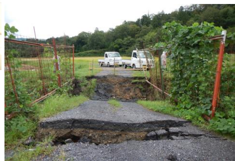
東寺地先農道橋落橋
