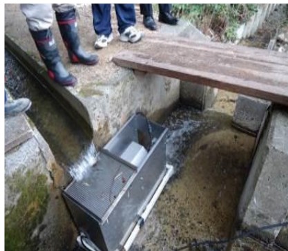
農業用水路を活用したピコ発電
