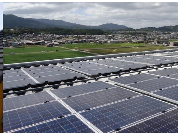
貳号機 甲陸市民発電所
