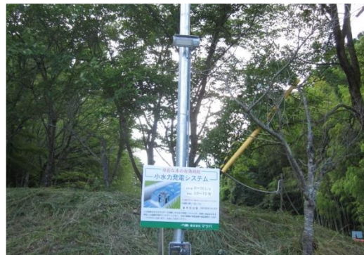
ピコ発電による外灯（LED 照明）
