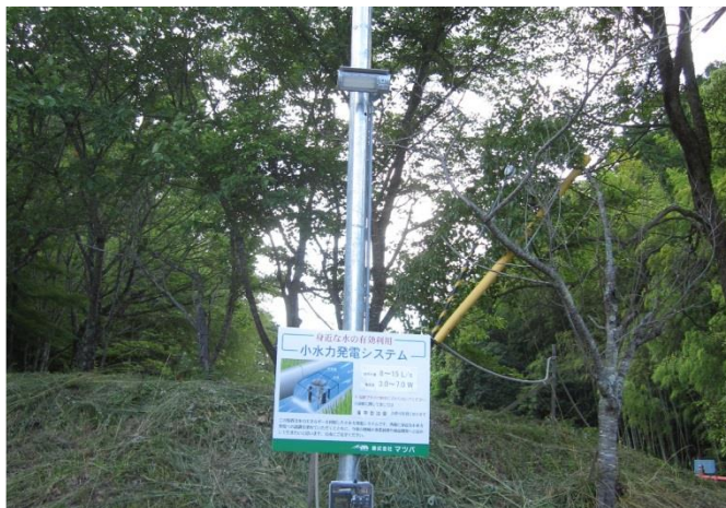
農業用水路を活用したピコ発電
