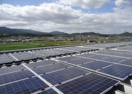
弐号機(105.6kw) 甲陸市民共同発電所
