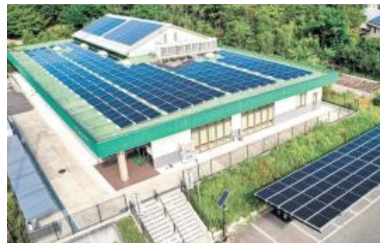
まちづくりセンターに設置している太陽光パネル
