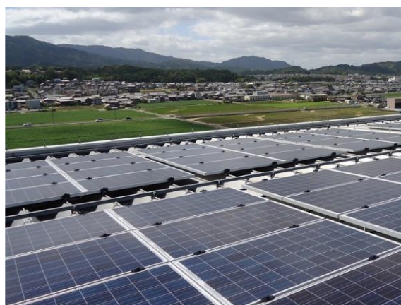
弐号機 甲陸発電所
