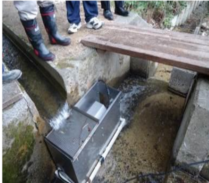
農業用水路を活用したピコ発電
