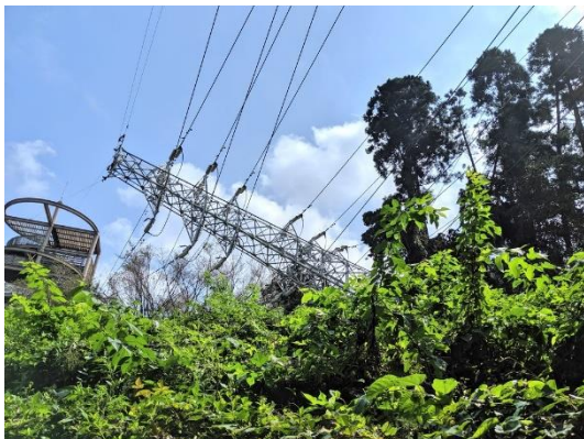
令和元年台風 15 号による被害 (資料：立憲民主党ウェブサイト)
