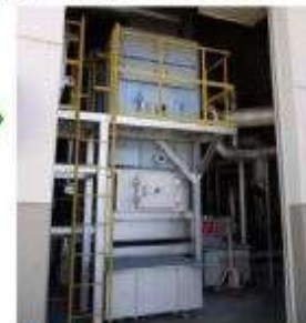
チップボイラー 熱供給
