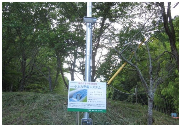
農業用水路を活用したピコ発電
