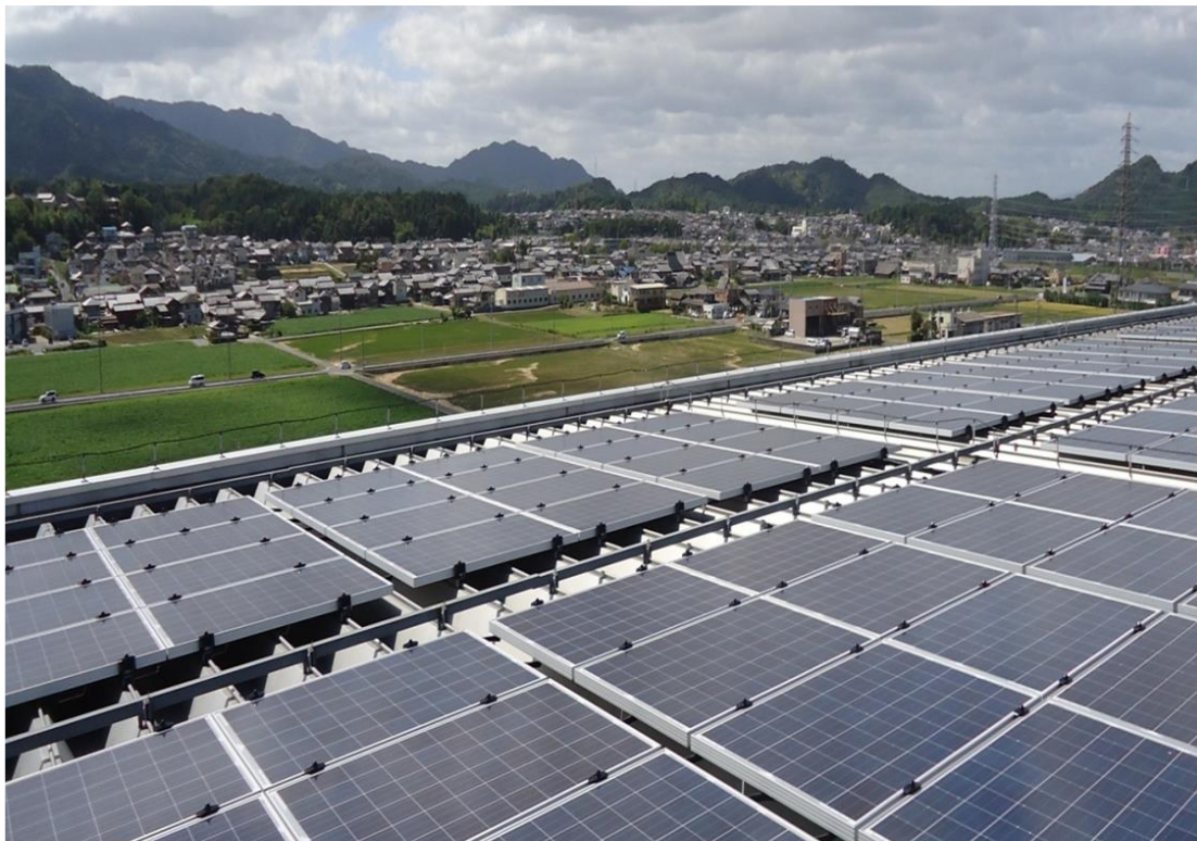
コナン市民共同発電所 4基稼働
