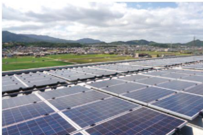
コナン市民共同発電所式号機 甲陸発電所
