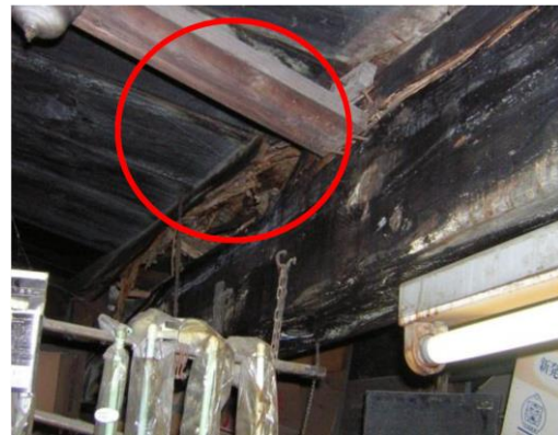
柱・はり接合部の腐朽
