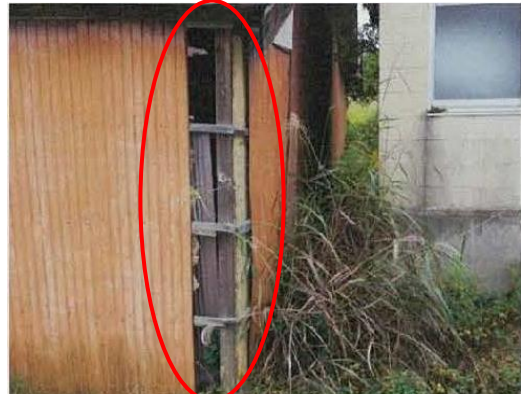
外装材の脱落
