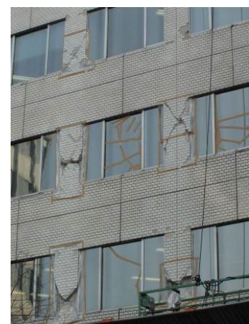
▲福岡県西方沖地震による 外壁・窓ガラスの破損
