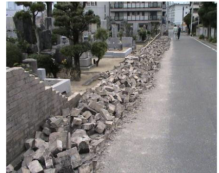
▲福岡県西方沖地震による ブロック塀の倒壊
