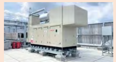
非常用発電機：伊丹市
