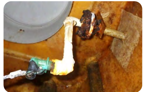
東庁舎給水設備
