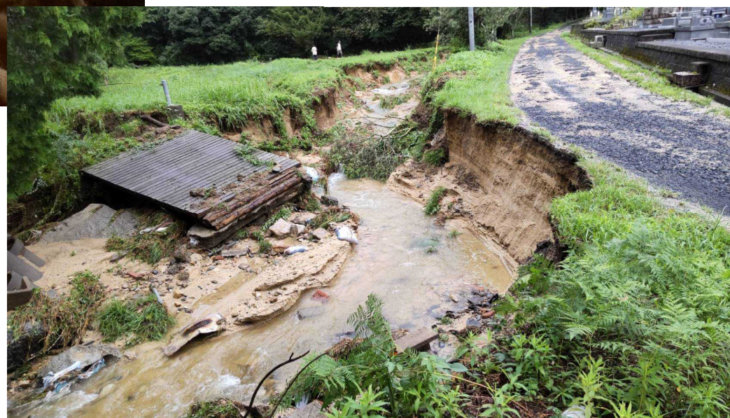
夏見里道崩落（夏見地先）
