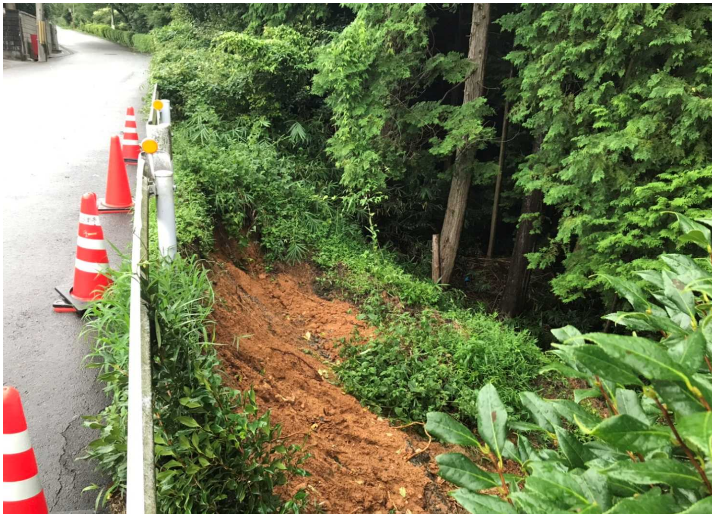
市道美松線法面崩壊（平松地先）
