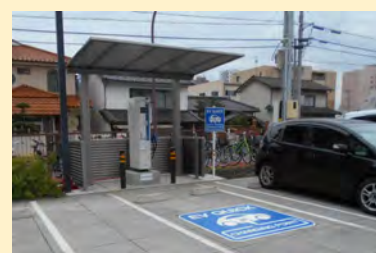
電気自動車用急速充電器：長野市
