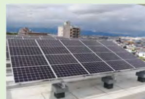
屋上の太陽光発電システム：守山市
