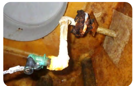
東庁舎給水設備
