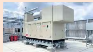
非常用発電機：伊丹市
