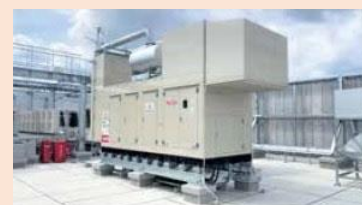
非常用発電機：伊丹市
