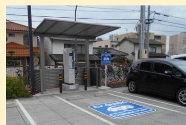
電気自動車用急速充電器：長野市
