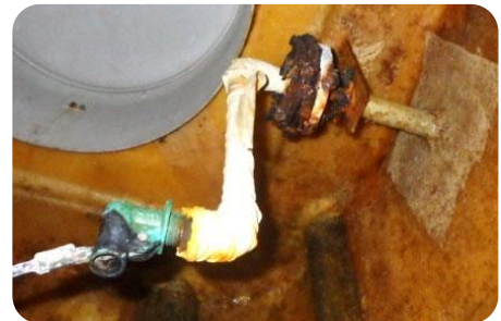
東庁舎給水設備
