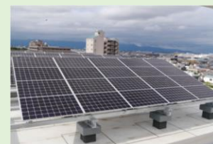
屋上の太陽光発電システム：守山市
