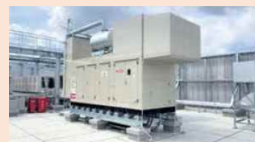
非常用発電機：伊丹市
