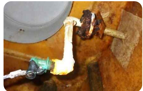
東庁舎給水設備
