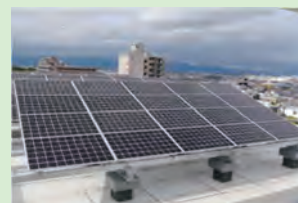
屋上の太陽光発電システム：守山市
