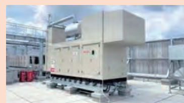
非常用発電機：伊丹市
