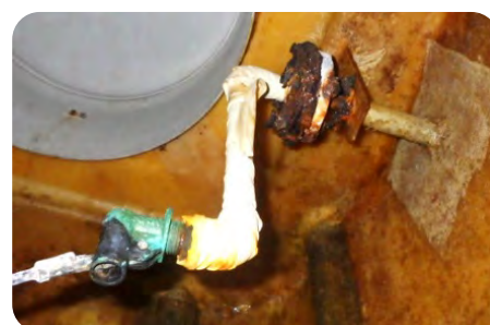
東庁舎給水設備
