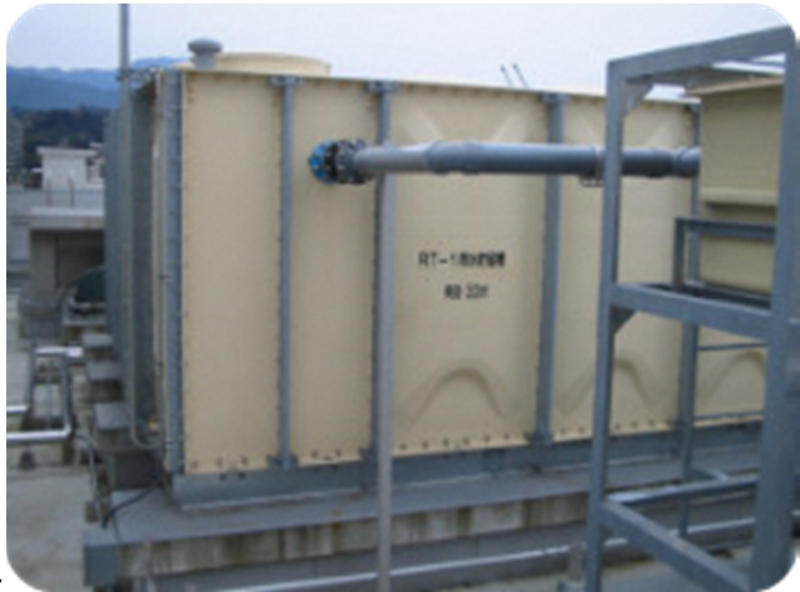
小田原合同庁舎: 雨水貯水施設
