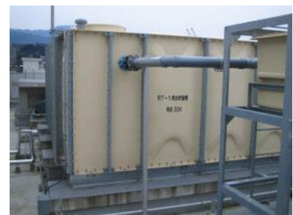
小田原合同庁舎：雨水貯水槽
