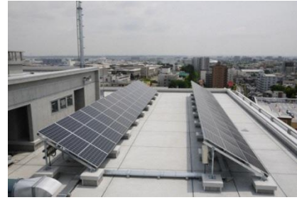
平塚市：太陽光パネルを設置した屋上
