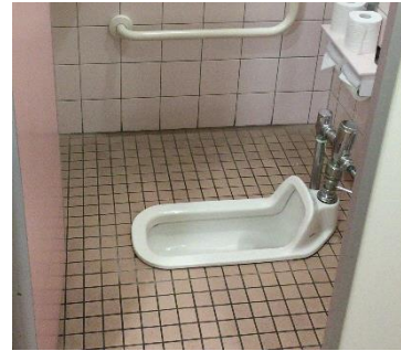
バリアフリー化されていないトイレ
