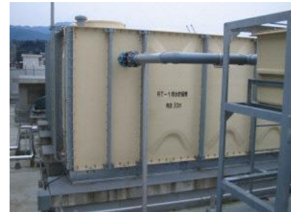
小田原合同庁舎：雨水貯水槽
